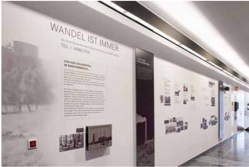
Sonderlösung einer Flurbeleuchtung mit einem direkt asymmetrisch und indirekt unter 28° strahlendem Lichtband aus Aluminium-Profilen
